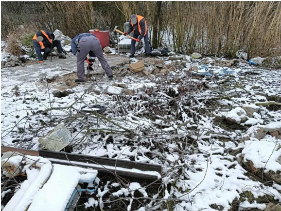
Pod nadzorem strażników miejskich osoby osadzone wykonały szereg robót rozbiórkowo-porządkowych pod plac zabaw dla dzieci w Neryngowie.
