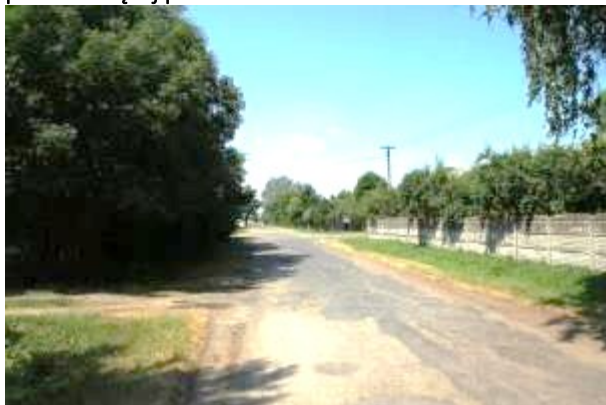
Zniszczona nawierzchnia asfaltowana drogi lokalnej przechodzącej przez centrum Goniczek
