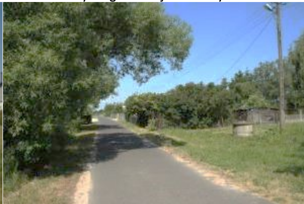
Stan techniczny drogi lokalnej w Nadarzycach
