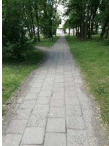
Zdjęcie 62 Zdegradowana nawierzchnia terenu zielonego przy dworcu kolejowym we Wrześni.
