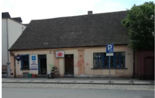
Zdjęcie 19 Zdegradowany budynek usługowo-mieszkalny przy ul. Warszawskiej we Wrześni.
