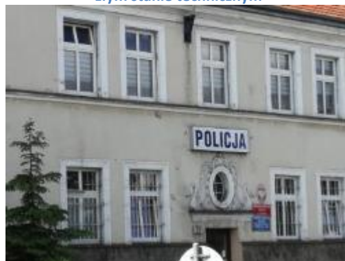
Zdjęcie 15 Elewacja budynku Komendy Powiatowej Policji w złym stanie technicznym
